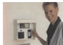
Sicherheits- und Zutrittskontrolle
